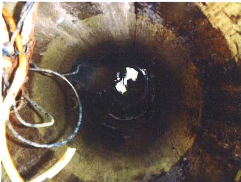
Figur 2. Oljeavskiljare OA3 vid framsidan av hangar C1.
