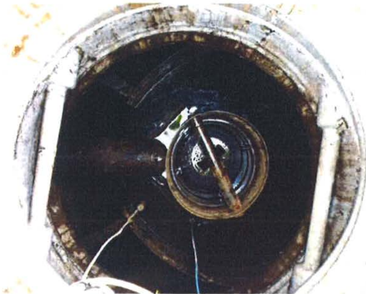
Figur 1. Oljeavskiljare OA2 vid tankplattan vid Shells bränsletankar. Oljeavskiljare OA1 är utformad likadant.
